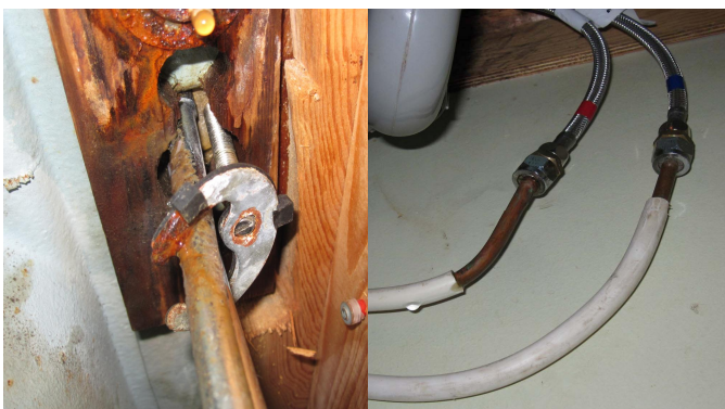
Tva exempel dar en kran och en koppling orsakat vattenskadorna.
